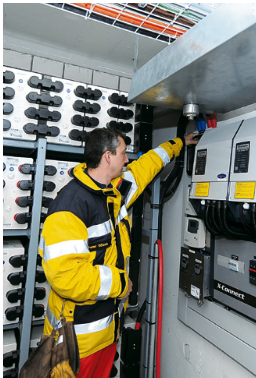
Mit dem Trennschalter lässt sich das Kraftwerk am Dach von der Haustechnik trennen.
