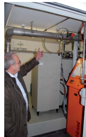
Ein Blockheizkraftwerk erzeugt gleichzeitig Strom und Wärme.
